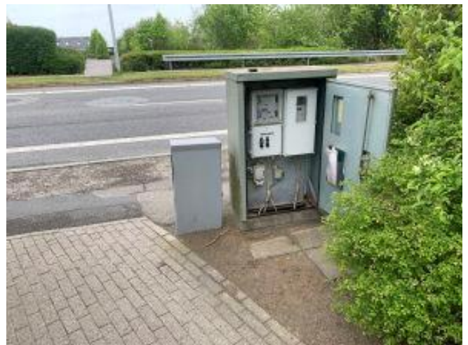
Det gamle styreskab, som ikke længere er i brug
