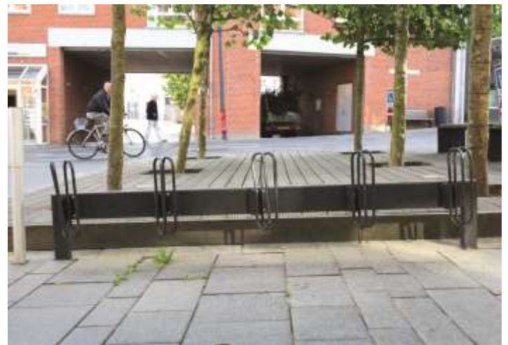
Mindre skævvridninger af cykelstativer er acceptabelt. Bliver det værre end på billedet her, skal det rettes op.
