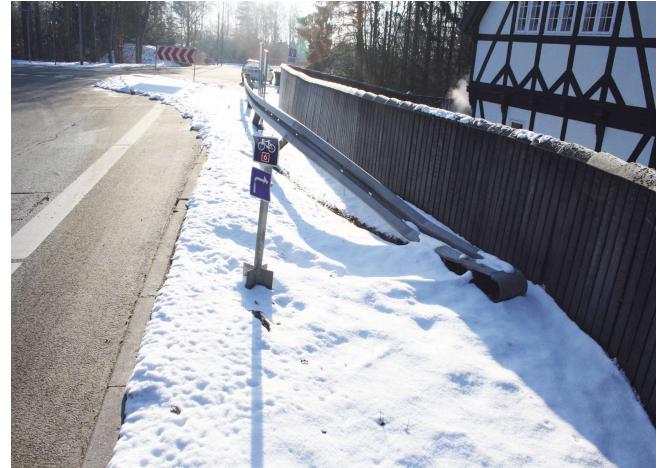
Defekt autoværn som bør repareres.
