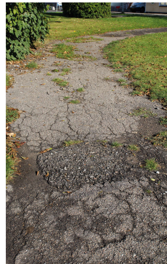
Asfaltbelægning med en uacceptabel ukrudtsmængde.
