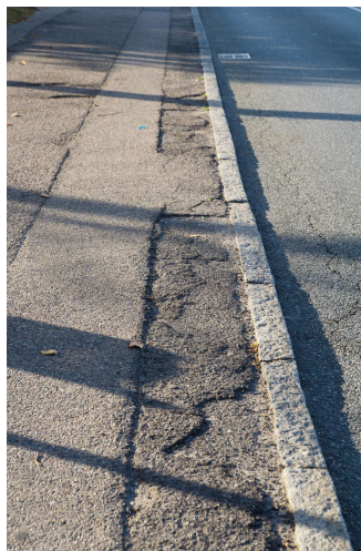
Uden at denne asfaltbelægning er prangende overholder den dog kravene til rethed og højdeforskelle. Belægningen er imidlertid kun acceptabel fordi den ikke er nyanlagt.
