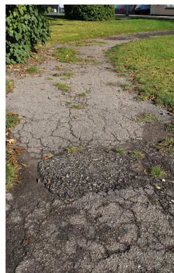
Asfaltbelægning med en uacceptabel ukrudtsmængde.
