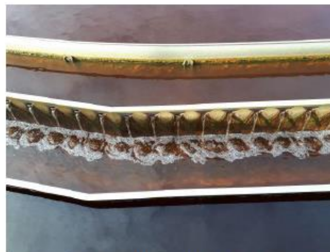
Renset spildevand fra efterklaringstank, men før efterpolering.
