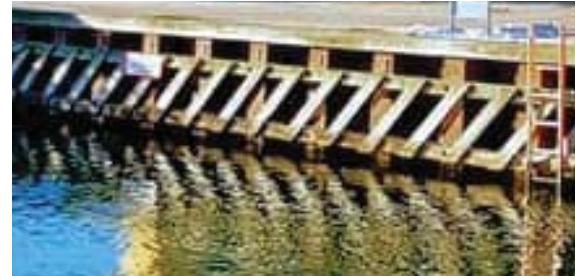
Bolværk i Skælskør Havn. Foto: Rasmussen B.
