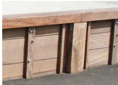
Stormflodssikring på Omø, Klimatilpasning.dk
