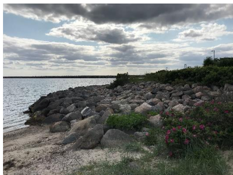
5. Stenbeskyttelse ved vendeplads. Stranden slidt af færdsel
