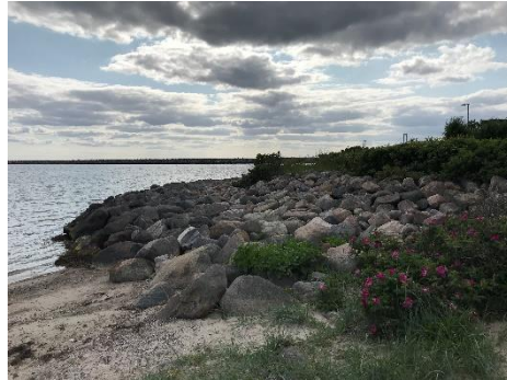
5. Stenbeskyttelse ved vendeplads. Stranden slidt af færdsel
