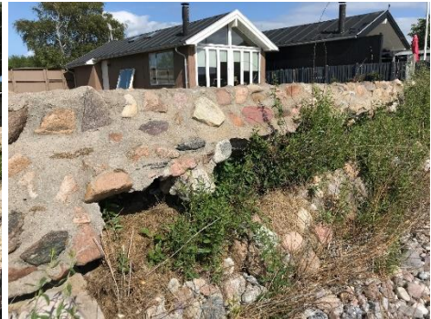
2. Nærbillede af skadet mur.
