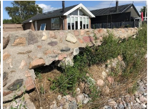
2. Nærbillede af skadet mur.
