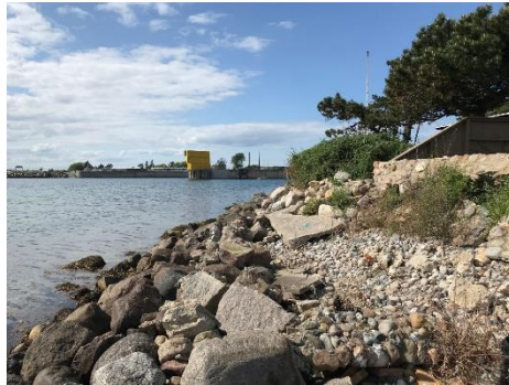
1. Stenkastning med skadet væg nordligste del.
