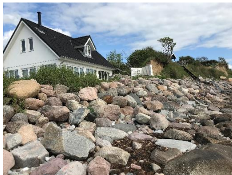
3. Skråningsbeskyttelse af pynt, Pilevænget 31.
