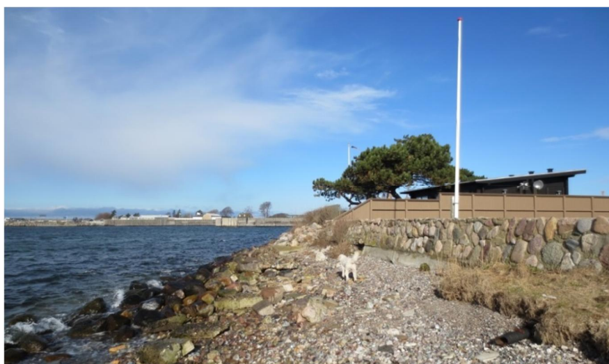
Figur 3-12 Kysten set fra syd mod nord midt på Delområdet med stenskråningsbeskyttelse udfor det nordligste og yderste hus og stenbeskyttelse med betonbrokker ved vandlinjen syd herfor.
