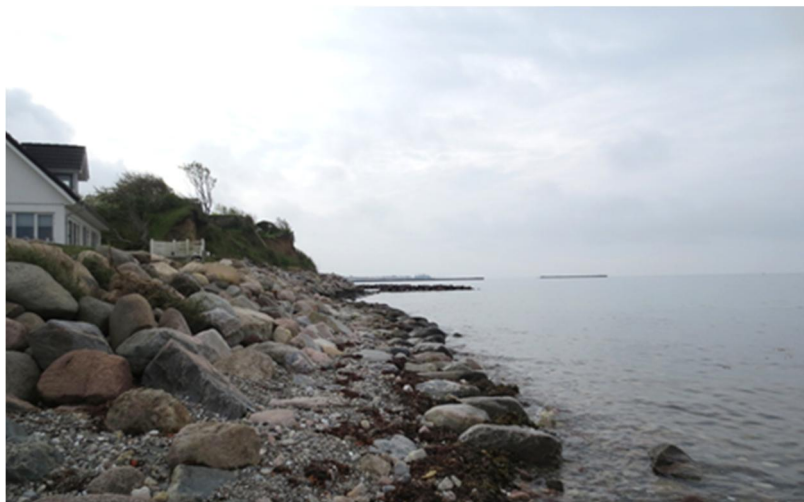
Delområde C set mod syd ved pynten hen mod klinten. Bemærk: den kraftige stenskråningsbeskyttelse.
